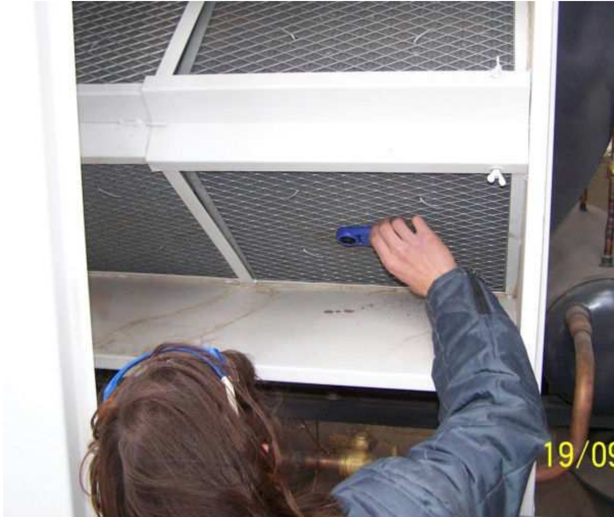
Figura 3: Medición del caudal de aire en los paneles de toma de aire del equipo.
