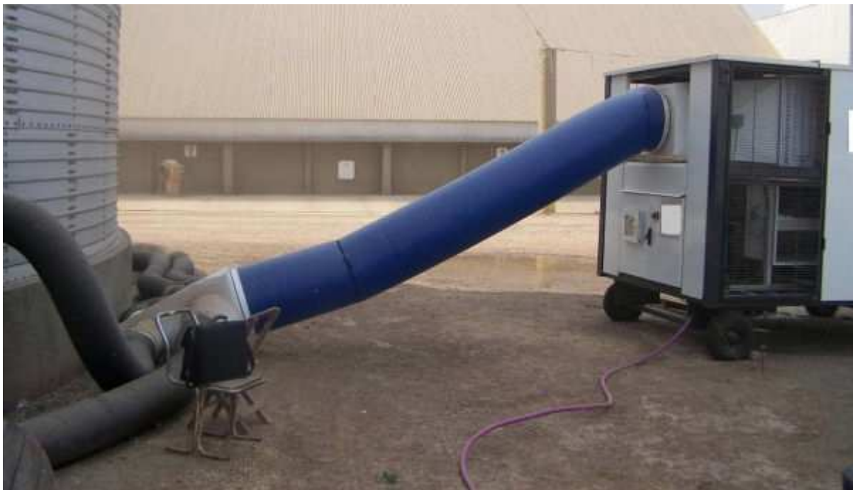
Figura 1 y 2. Superior: conexión al silo mediante conducto de 300 mm de diámetro. Inferior: vista general de la conexión entre el equipo refrigerador y el silo.
